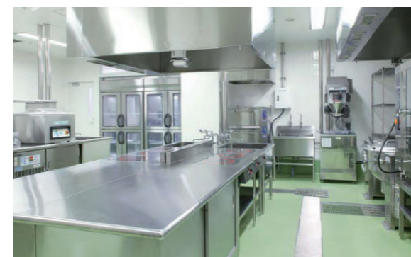
オール電化厨房
